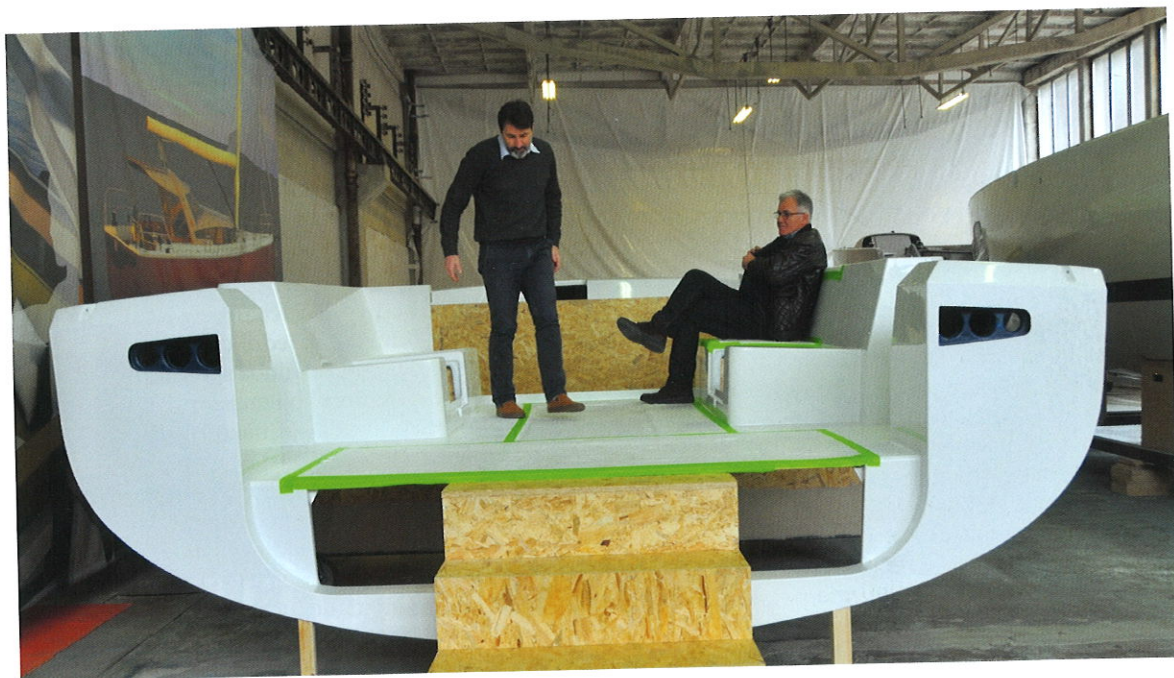
Pod jednom klupom smještena je sva elektronika, a pod drugom vodo-instalacije
